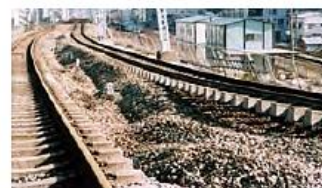
鉄道普通盛土の被災状況
