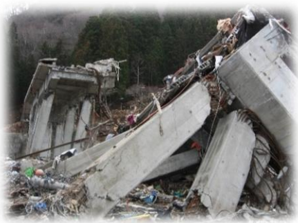
倒壊した鉄道高架橋（鳥越駅） （2011年東日本大震災）
