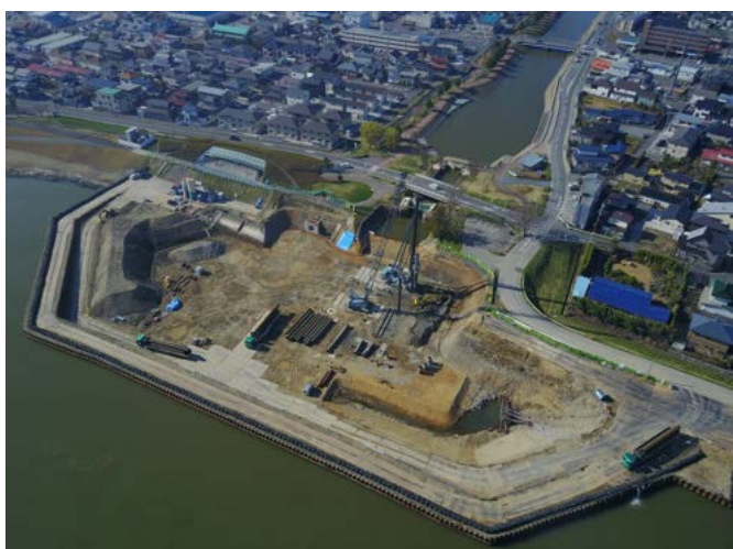
被圧地下水条件でのガンテツパイル工法実績 (水門工事)
